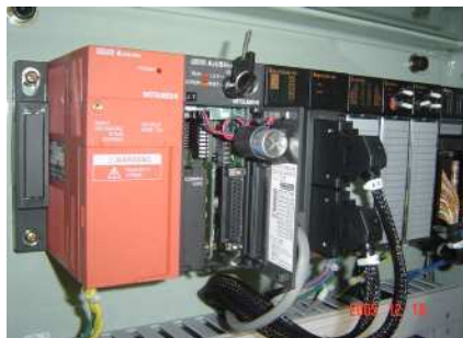
三菱電機株式会社製 PLC(Aシリーズ)
