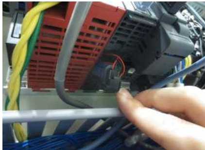
三菱電機株式会社製 PLC(Qシリーズ)
